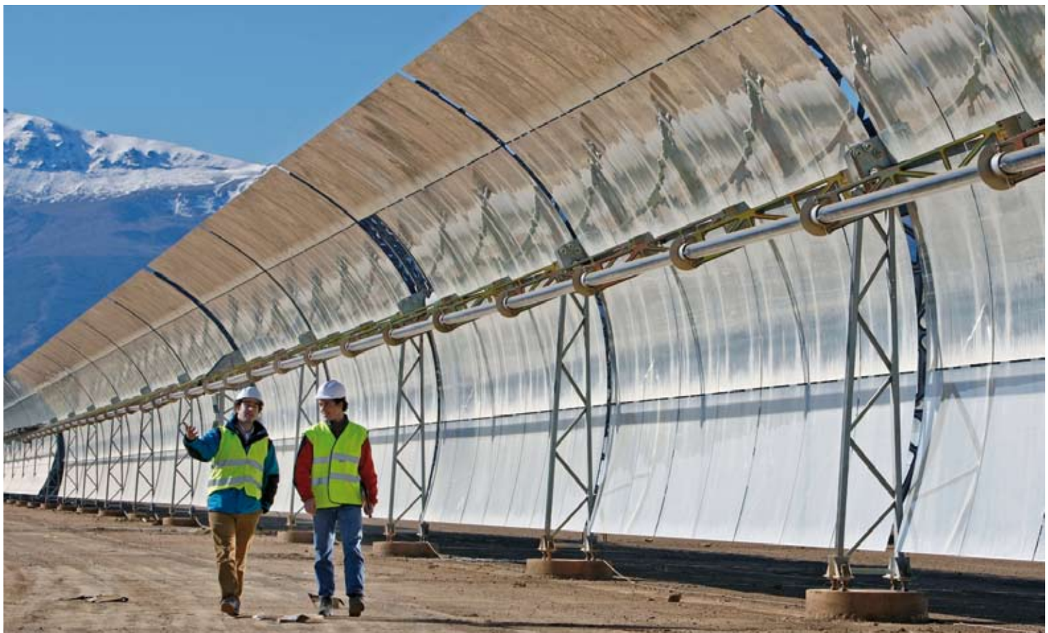
Beim solarthermischen Kraftwerk „Andasol 1“ konzentrieren parabolisch geformte Spiegel die Sonnenstrahlen auf Solarreceiver. Die speziell beschichteten Edelstahlrohre mit einer Hülle aus Spezialglas sind das Herzstück der Anlage
