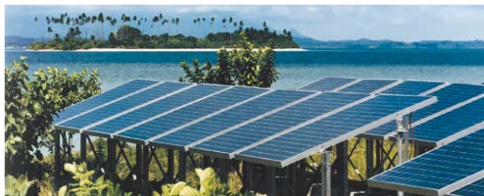
In strukturschwachen Gebieten Indonesiens profitiert man von netzfernen Solarstromanlagen
